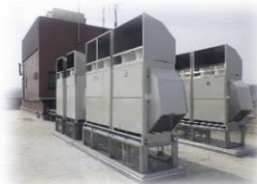
高効率空調設備室外機
